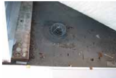
Photo No 106A (roof debris)
